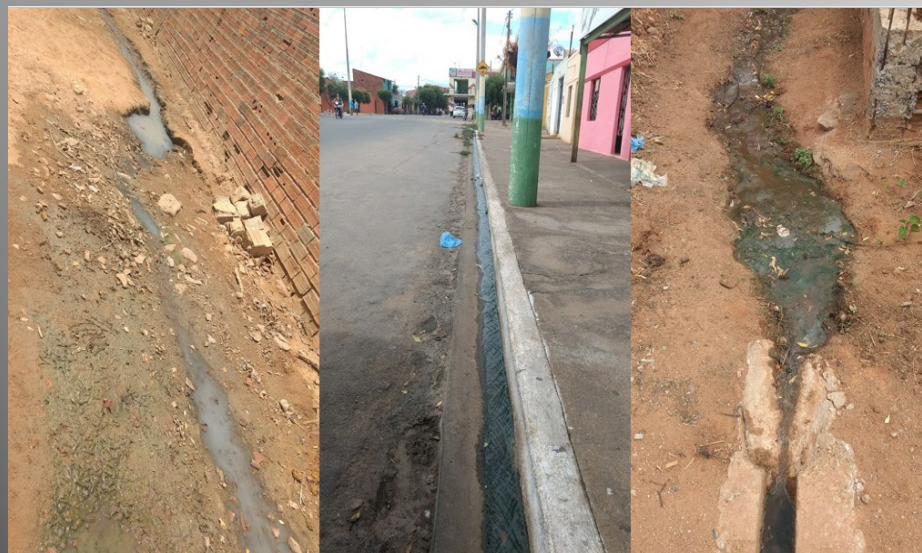
Lançamento de efluente doméstico a céu aberto de comunidades lindeiras próximas a Barragem Taquara
